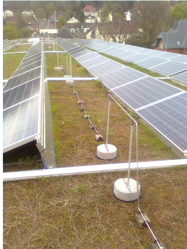
(Quelle: Fritz Mauermann Blitzableiter- und Elektrobau GmbH & Co. KG)
