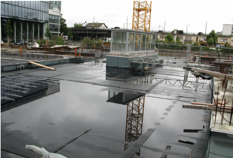
Abb. 6: Großflächige Tiefgaragendecke ohne Gefälle. Das stehende Wasser kann zum Problem werden.
