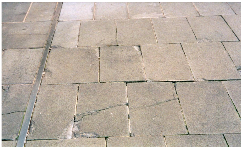
Abb. 8: Hohe Druckbelastung bei noch gebundenem Untergrund führt zu erheblichen Belagsschäden. Hier als Totalschaden.
