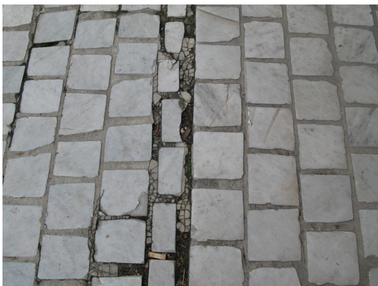
Abb. 9: Die Bewegungen der Bauwerksfugen schlagen hier voll im Belag durch. So hilflos planen und bauen Profis nicht.
