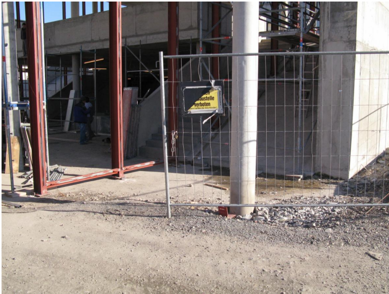
Abb. 5: Geringe Anschlusshöhen hier im Rohbau vor der Tür sind immer problematisch; insbesondere bei Betondecken ohne Gefälle.
