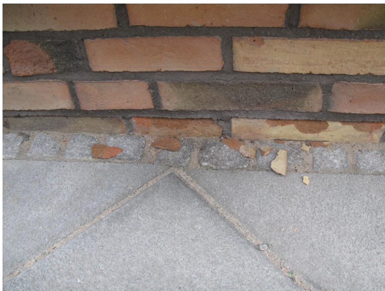
Abb. 10: Fassadenanschlüsse sind immer heikel. Niemals - wie hier - Beläge mit Pressdruck an hinterlüfteten Fassaden anschließen.
