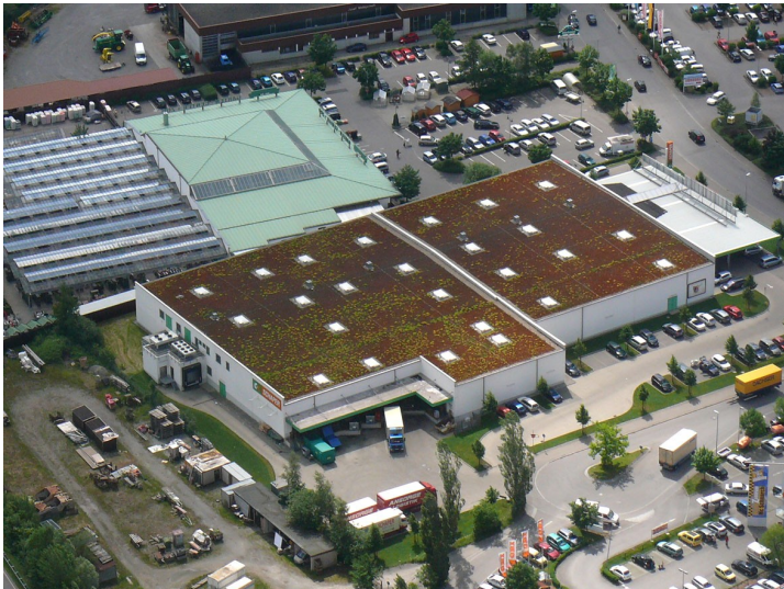
3. Etwas Pflege und Dünger würden der Begrünung auf diesem Firmengebäude im Ravensburger Industriegebiet an der B 32 gut tun
