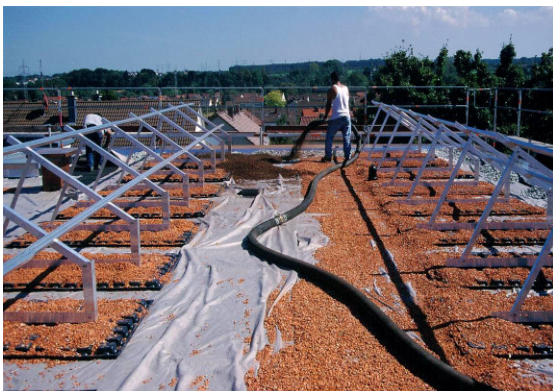
Abb. 4 Substrat als Auflast zur Montage von Photovoltaikanlagen
