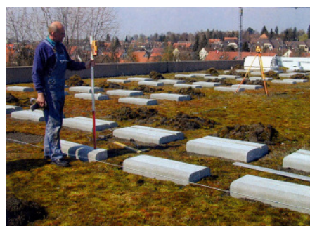
Abb. 3 Bordsteine als Auflast zur Montage von Photovoltaikanlagen
