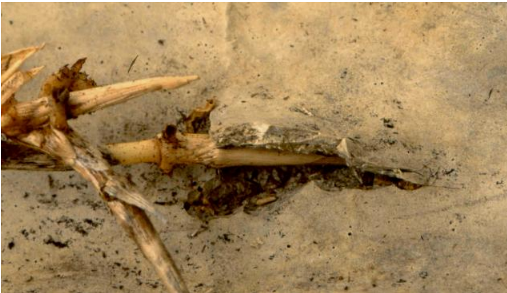
Abb. 4: In die Fläche einer PUR-Abdichtung eingedrunenes Rhizom
