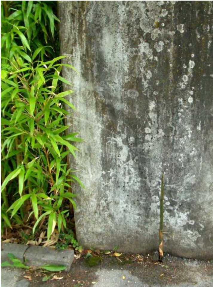
Abb. 1: Aus der Pflanzfläche entwichenes, durch einen Asphaltbelag gedrungenes Rhizom
