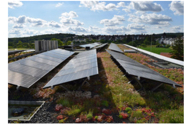
Abb. 16: Praxisbeispiel eines Solar-Gründaches mit Ost-West-Ausrichtung der PV-Module. Quelle: BuGG
