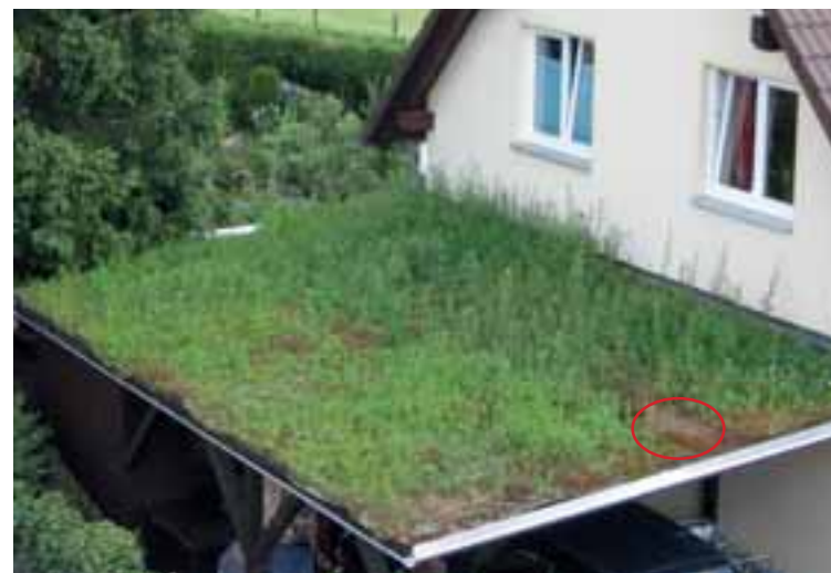
Abb. 8: Trockenschäden durch Bewässerungsfehler (oben) Juli 2010, (unten) Juli 2014 (Fotos: Mählmann).
