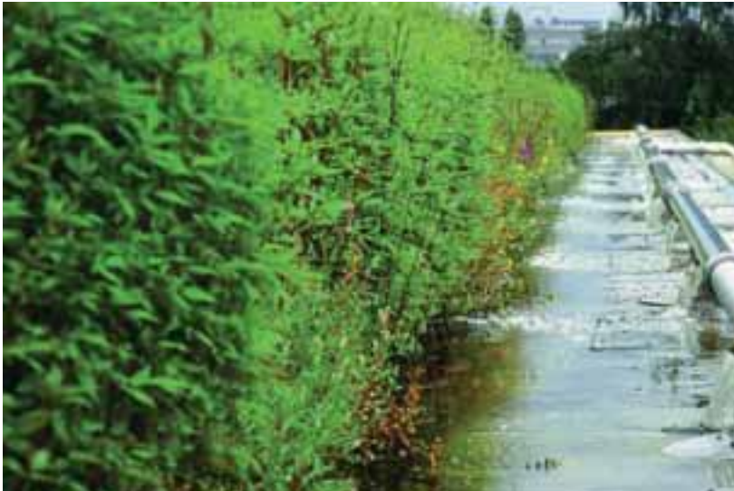
Abb. 3: Gleichmäßige Verteilung des zu kühlenden Wassers am Zulauf des Sumpfpflanzendaches. (Foto: Possmann).
